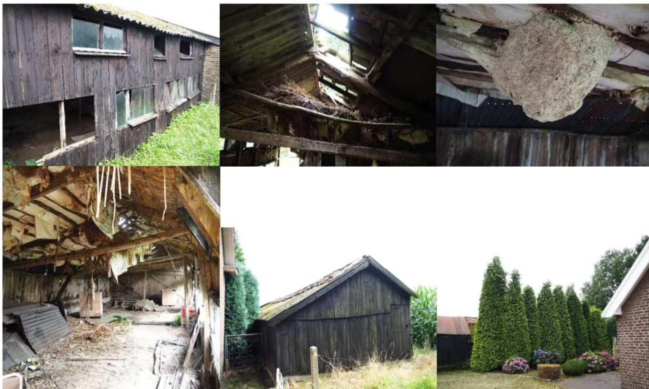
Figuur 4. De zuidelijke schuur (west) verkeerd in vergevorderde staat van verval met gaten in het dak en muren. Het dak bestaat uit stalen en asbest golfplaten met op het noorden ook dakpannen.
