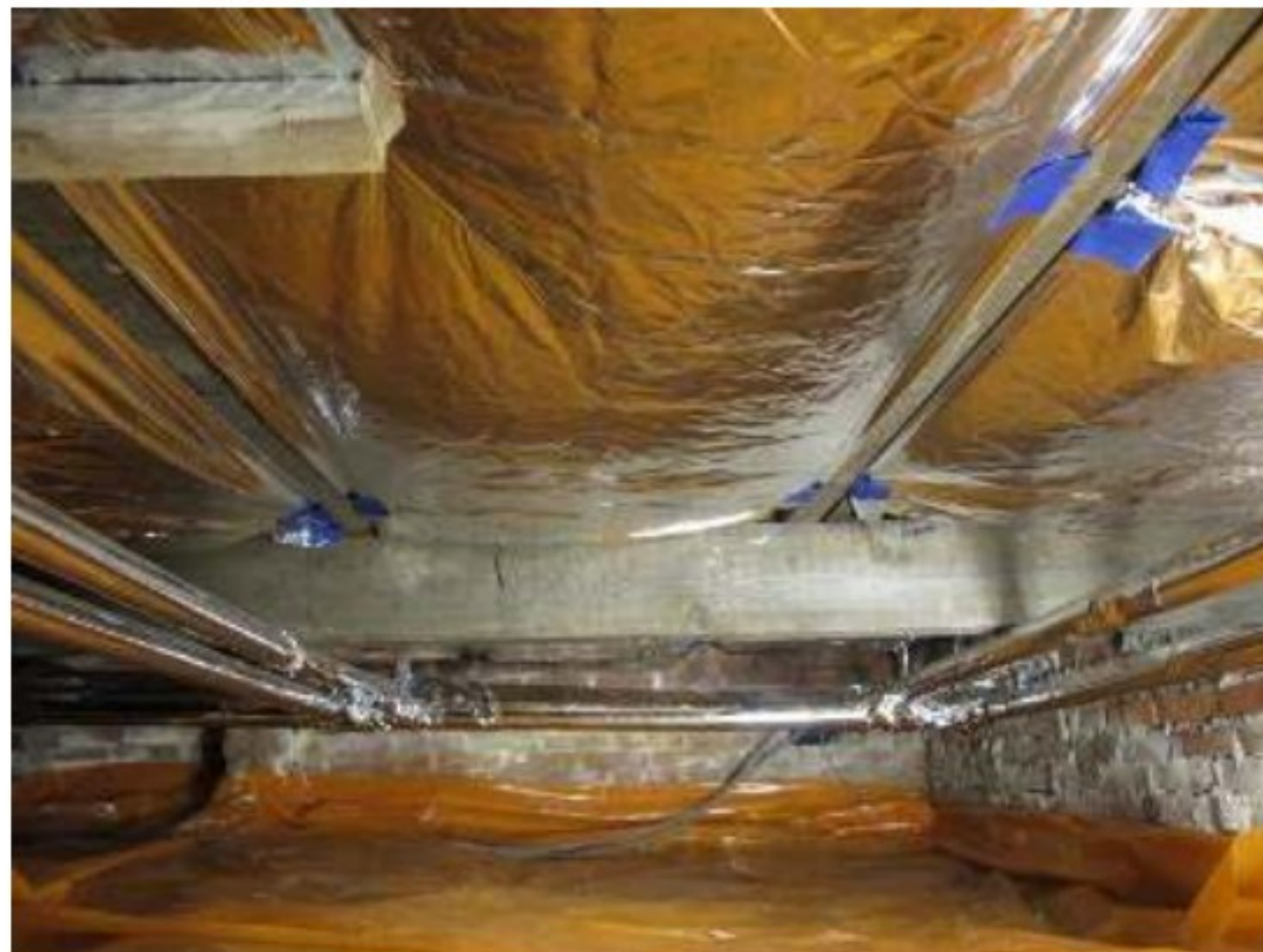
Aluminium zakken onder vloer
