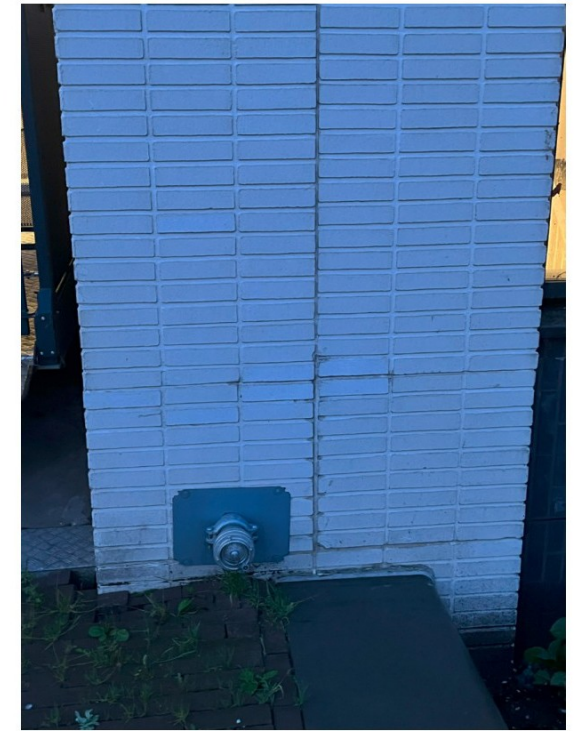
patroon niet afgestemd op naden
