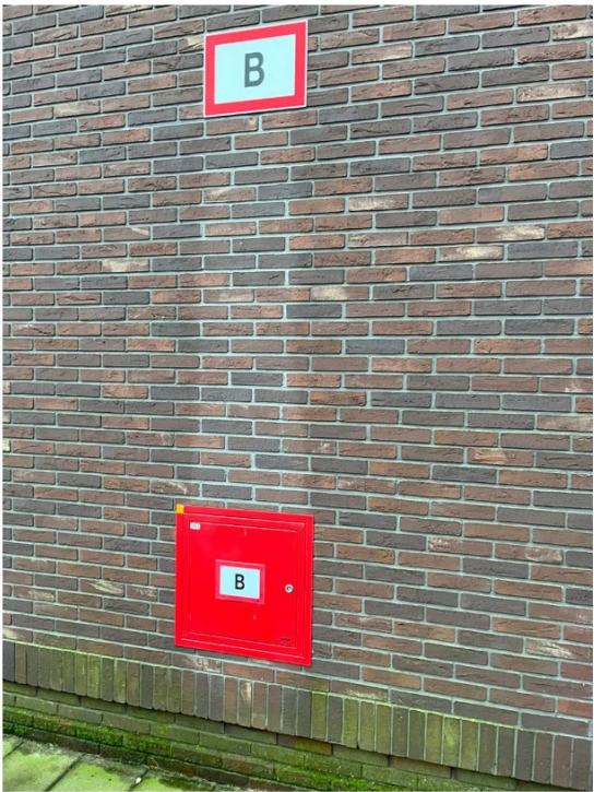
gemetselde gevel in slechtere staat
