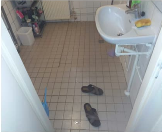
badkamer, vloertegels in specie/cement gezet, waarneembare riolering PVC
